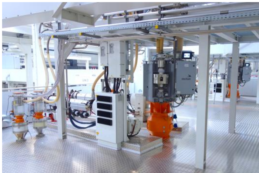
Abb.5: Zentrale Mischstation zur Versorgung des „Mahlgut-Extruders“. In ihr treffen vier Materialkomponenten (Mahlgut aus dem Silo oder aus dem Big-Bag, Stabilisator für den Haftvermittler und PP-Neumaterial) zusammen, die aus den gravimetrischen Dosiergeräten in der dritten Ebene zudosiert werden
